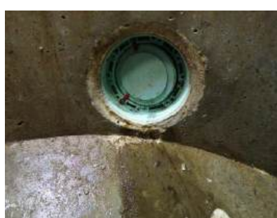
写真-2 金沢市 開放された消散弁
