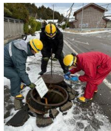
写真-2 マンホール浮上被害 場所-珠洲市(国土交通省能登地震取組み状況報告書より)
