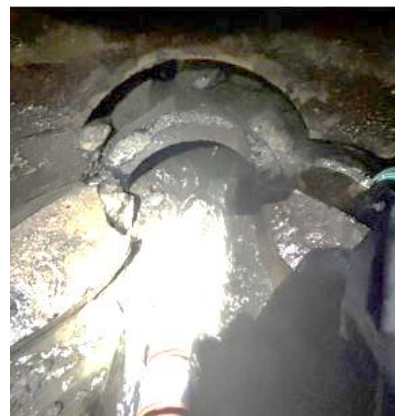
写真-1 管口の突出被害状況 場所-不明(国土交通省 能登地震 取組み状況報告書より)
