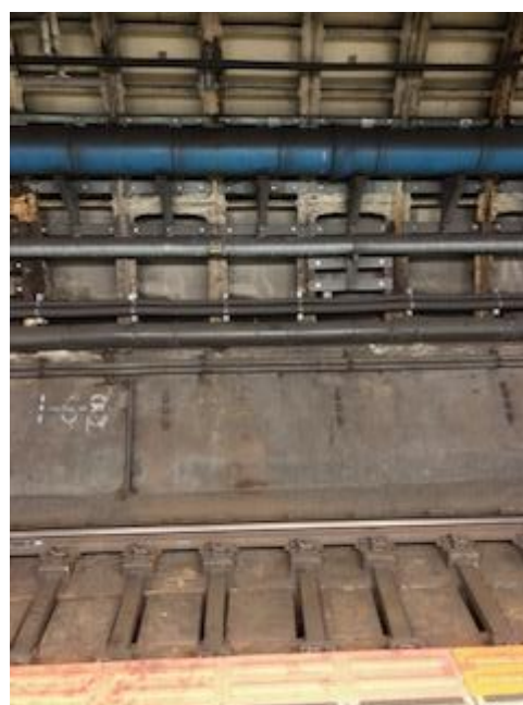
写真-8 新橋駅横須賀線地下ホームから見た送水管(水色)
