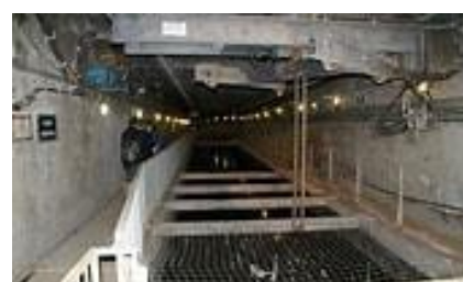
写真-6 伏せ越しに設けられた排出設備
