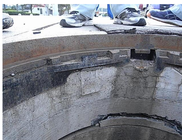
(写真-6) 側塊のずれと継ぎ目の損傷
