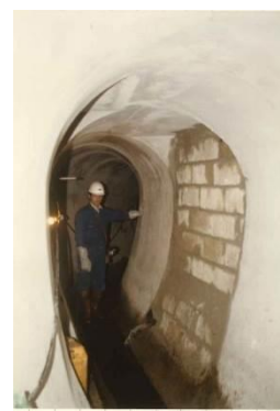
写真-8 ブロックで閉塞された下水管側接続部
