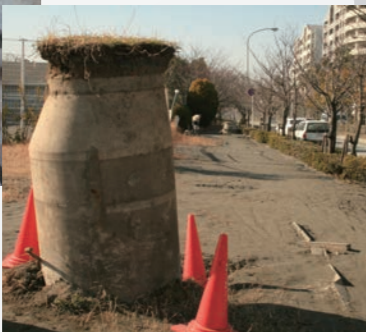
マンホールの浮上
