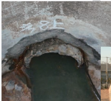
マンホールの損傷
