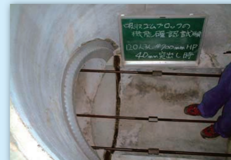
▲管の40mm突出し時の接続部確認 (管及びシーリング部ともに異常無し)
