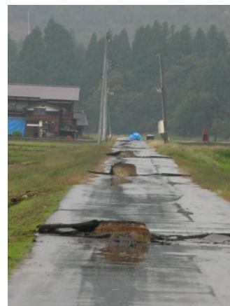
写真-3 液状化によるマンホール浮上
