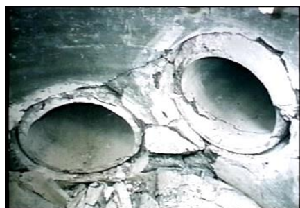
写真-3 マンホールと管口の損傷状況
