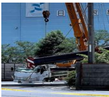
写真-1 岩国市のクレーン転倒事故
